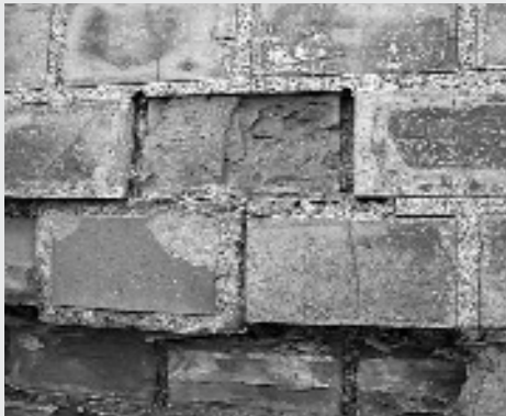
Abplatzen der hydrophoben Schicht.
