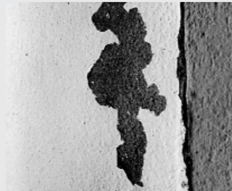
Hydrophobe Anstriche behindern die Austrocknung.
