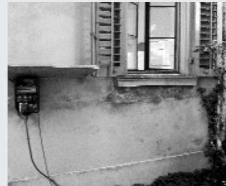
Feuchtigkeits hinterwanderung eines dichten Sockelputzes.
