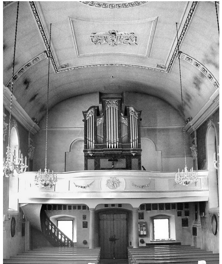
Abbildung 1: Innenansicht einer Kirche mit Verschwärzungen nur fünf Jahre nach der letzten und kurz vor der erneuten Innenreinigung.
