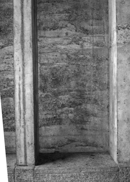
Der Originalbeton der Antoniuskirche zeigt grossflächig Kiesnester und offene Stellen.
